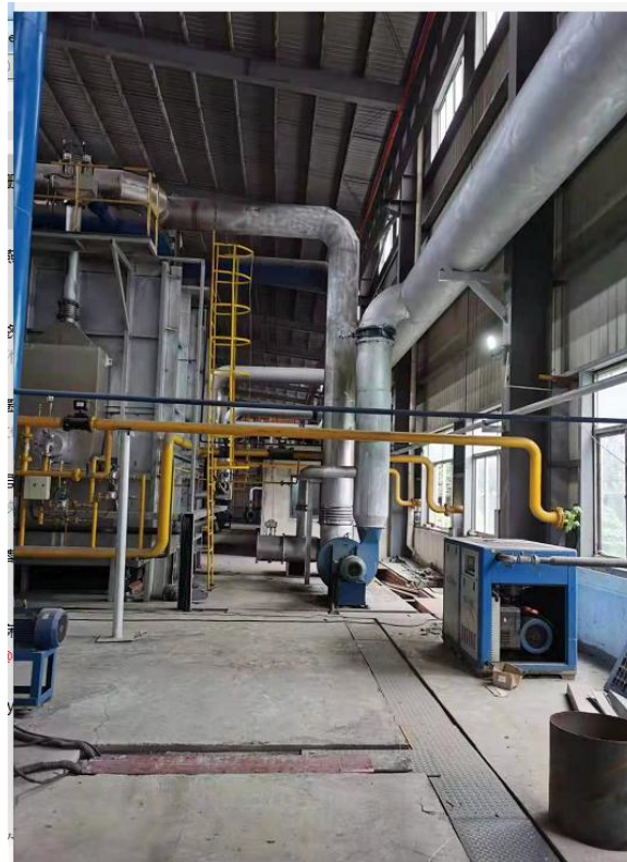
车间废气收集管道
